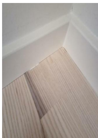
Minimal maling på gulvet ved fodlisten
